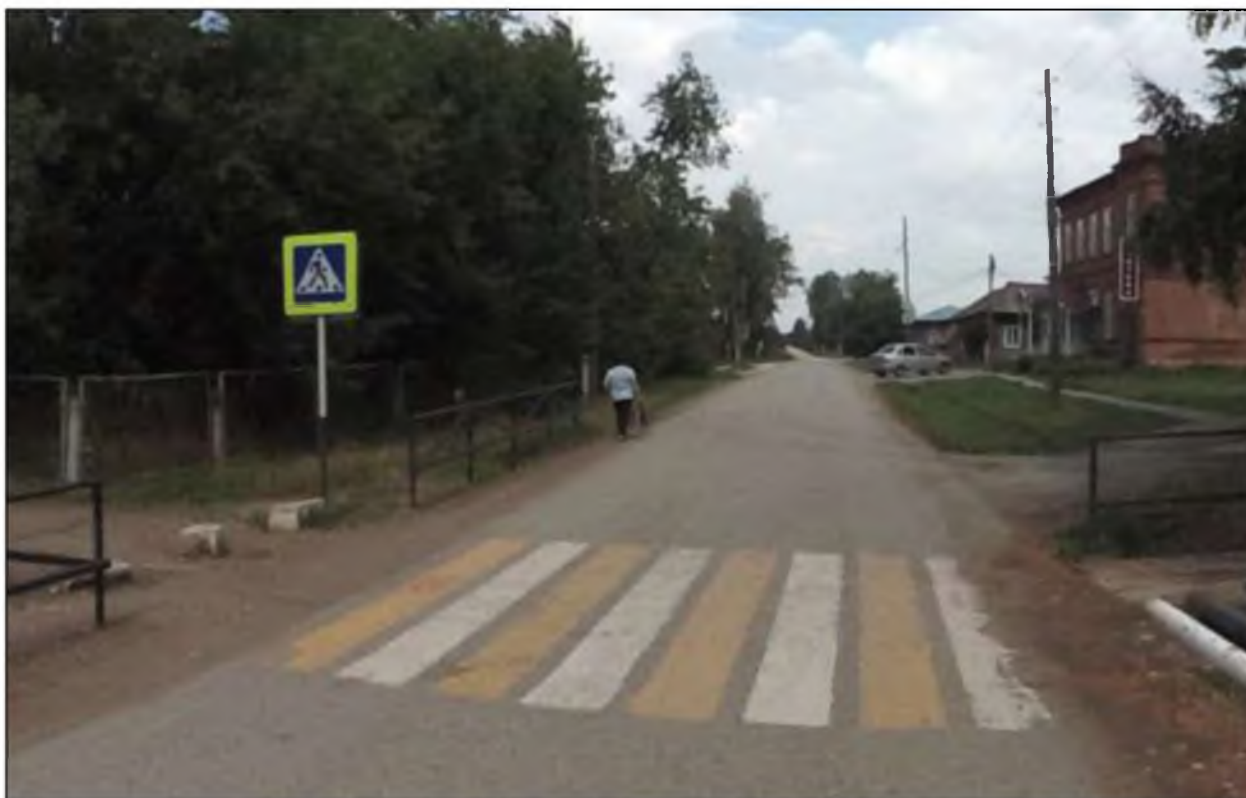
Рисунок 1.7.4 – Пример эксплуатационного состояния горизонтальной разметки 1.14.1 с желтым заполнением (обозначающей пешеходный переход) нанесённой в с. Орде по ул. 1 мая
