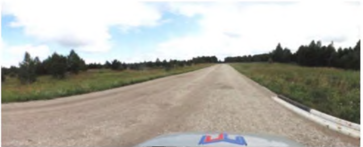
Рисунок 1.4.4 – Состояние дорожного покрытия а/д «Красный Ясыл – Межовка» на момент обследования
