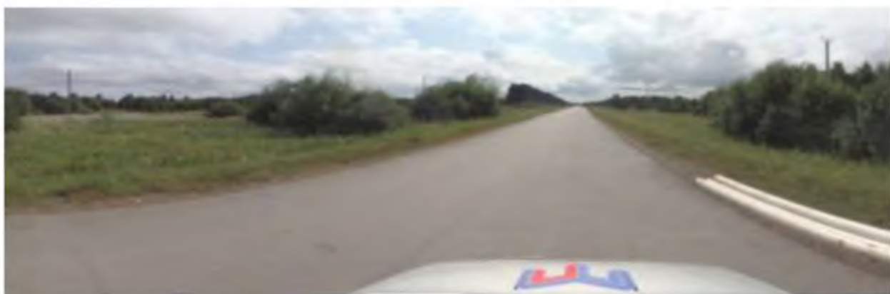
Рисунок 1.4.6 – Состояние дорожного покрытия а/д «Орда – Ашап» на момент обследования
