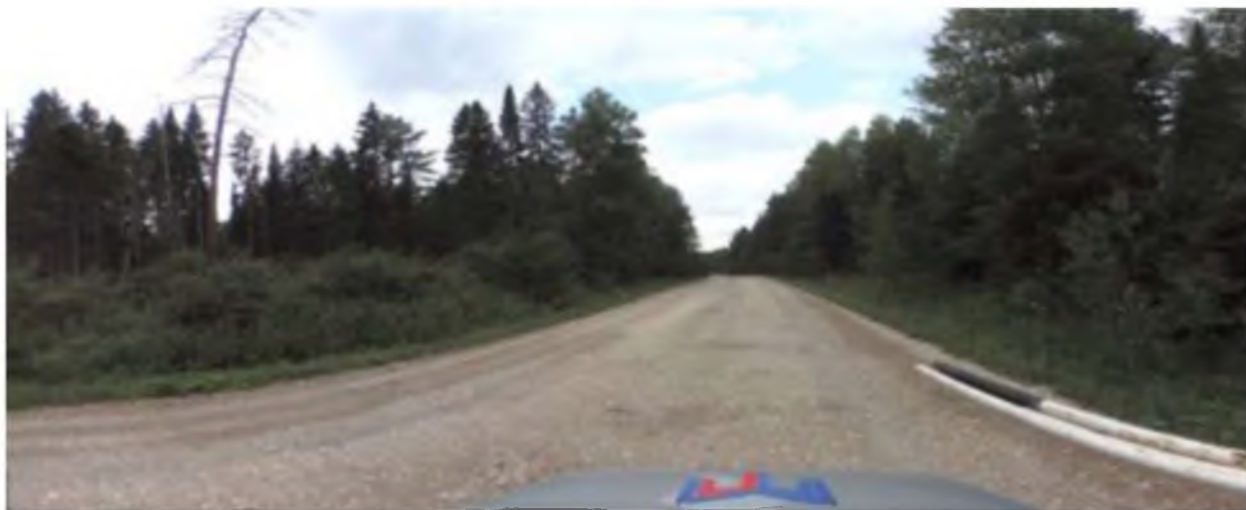
Рисунок 1.4.5 – Состояние дорожного покрытия а/д «Орда – Журавлево» на момент обследования
