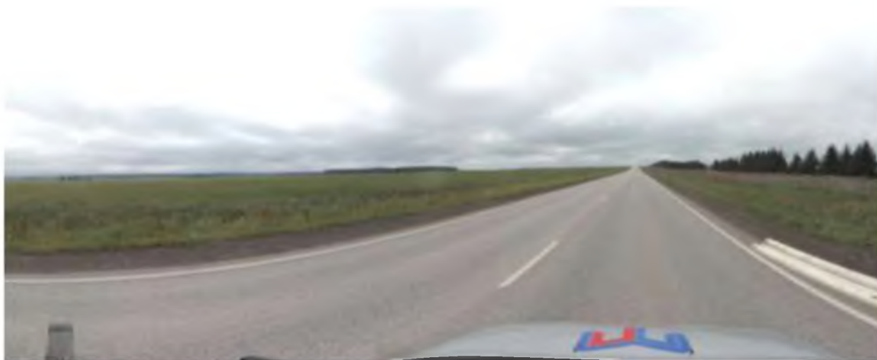
Рисунок 1.4.1 – Состояние дорожного покрытия а/д 57 ОП РЗ 57К-004 «Голдыри – Орда – Октябрьский» на момент обследования
