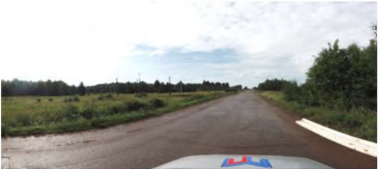
Рисунок 1.4.3 – Состояние дорожного покрытия а/д «Ашап – Сосновка» на момент обследования
