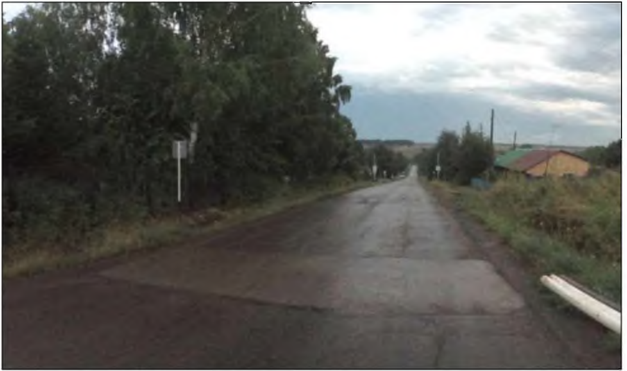
Рисунок 1.7.7 – Пример неудовлетворительного состояния ИН монолитной конструкции, расположенной в с. Ашап, пер Советский
