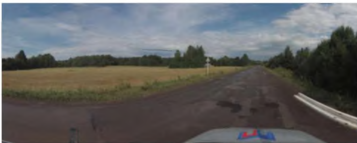
Рисунок 1.4.7 – Состояние дорожного покрытия а/д «Кунгур – Ашاپ» на момент обследования
